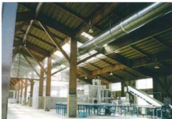
原臭吸引ダクト 900φ×2基
