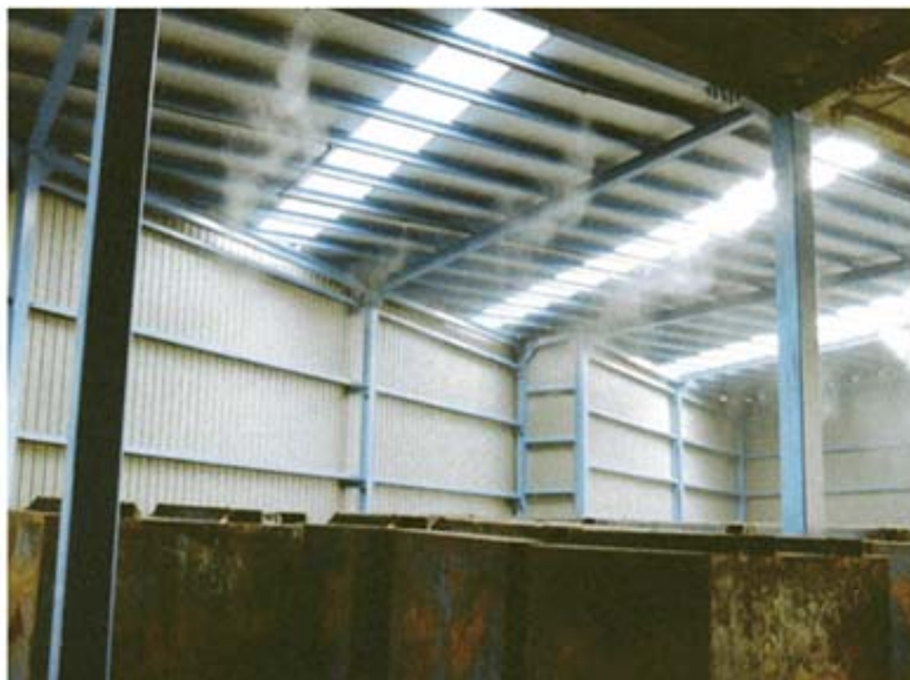
オゾン水細霧による脱臭。
