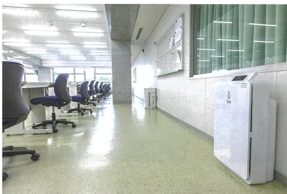
空気清浄機能と高濃度オゾン燻蒸機能を持つ「BT-180H」の設置例
